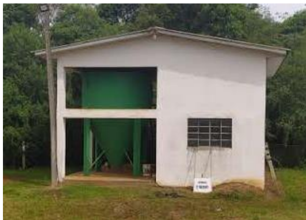
Figura 38 - Tratamento físico-químico inoperante.
